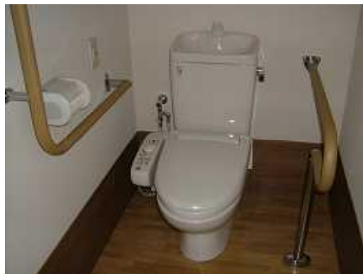
トイレ(シャワートイレ)
